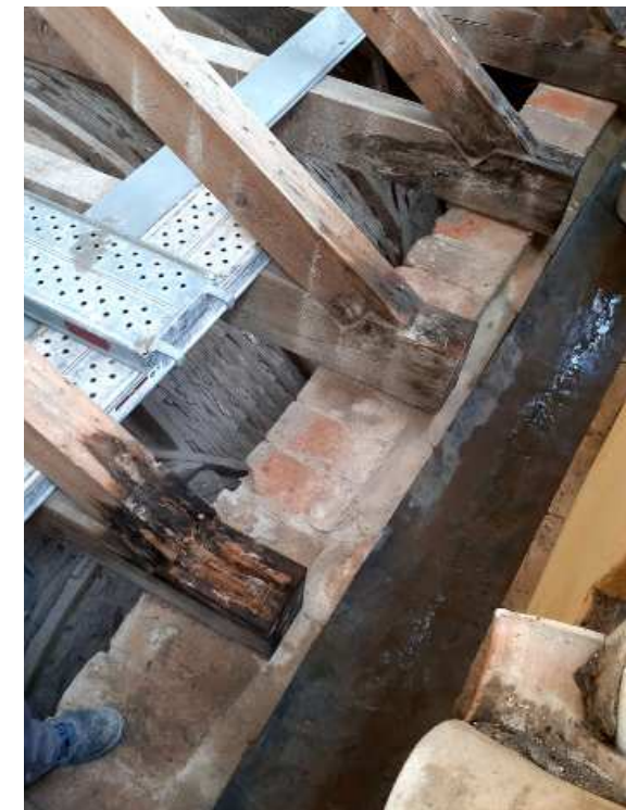
Figura III.1.8. Cerchas con ataques de hongos.
