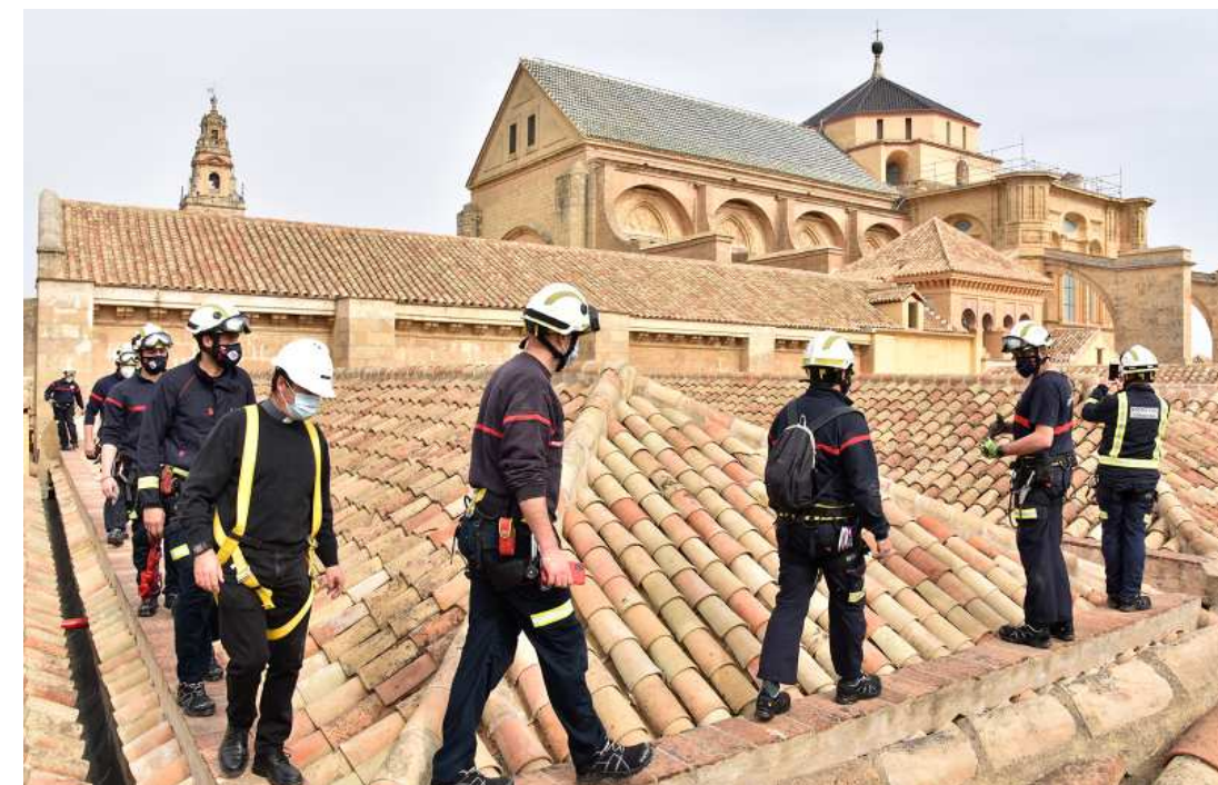
Figura III.1.3. Efectivos del Cuerpo de Bomberos durante una visita de reconocimiento al edificio.
