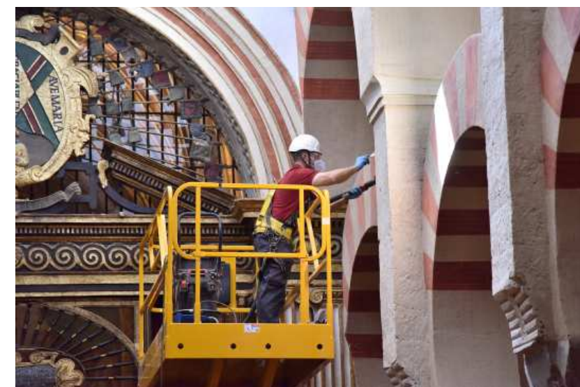
Figura III.1.12. Miembro del equipo de mantenimiento realizando labores de limpieza.
