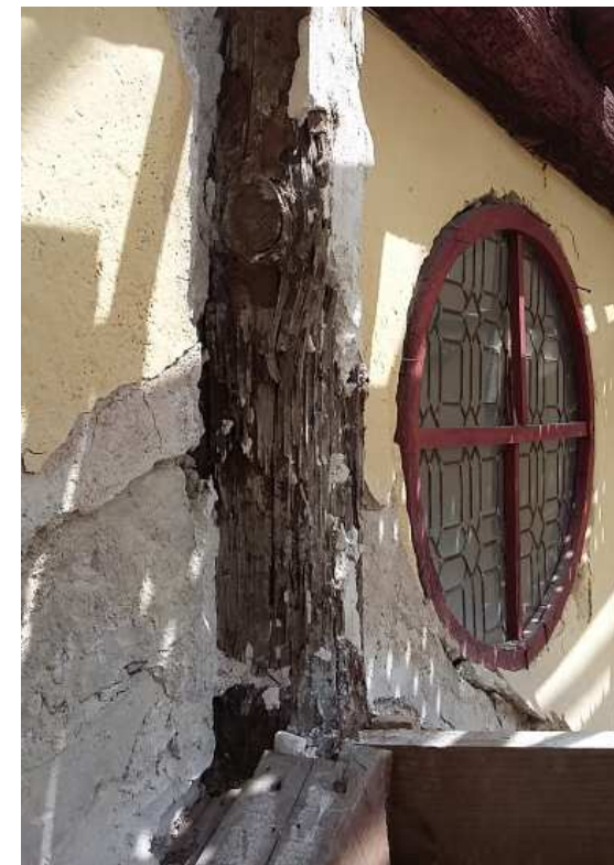
Figura III.1.10. Afección por xilófagos en pilar.
